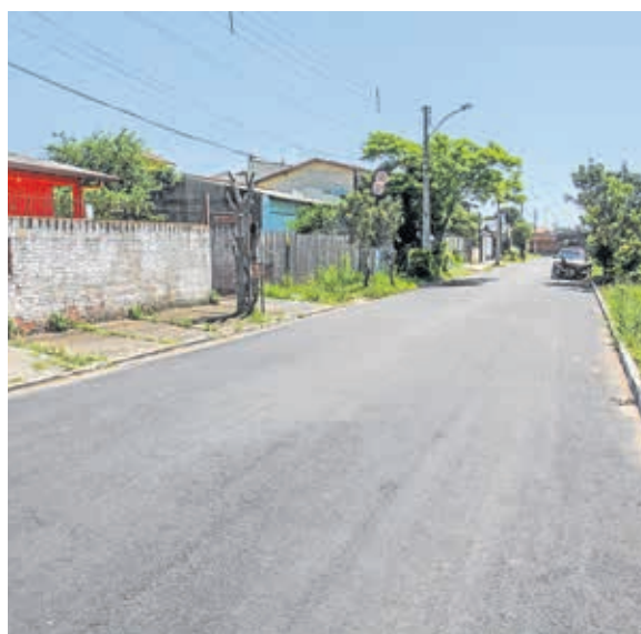
Asfalto da Rua Açai no Bairro Nova Estância
