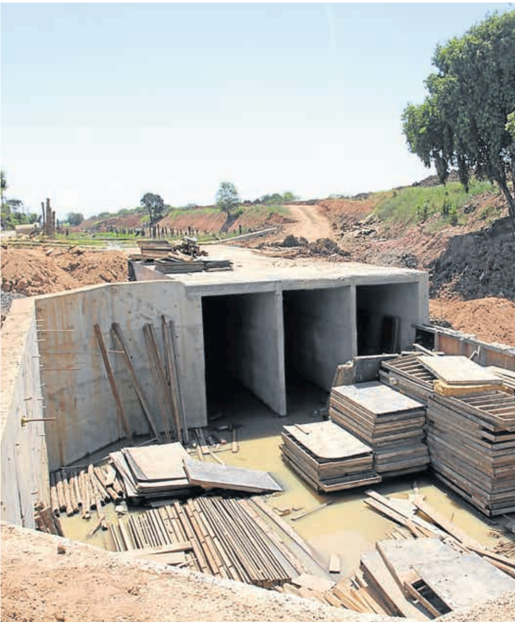
Casa de Bombas 8 vai reforçar prevenção a alagamentos no Mathias Velho, Vila Cerne, Cinco Colônias e Harmonia
