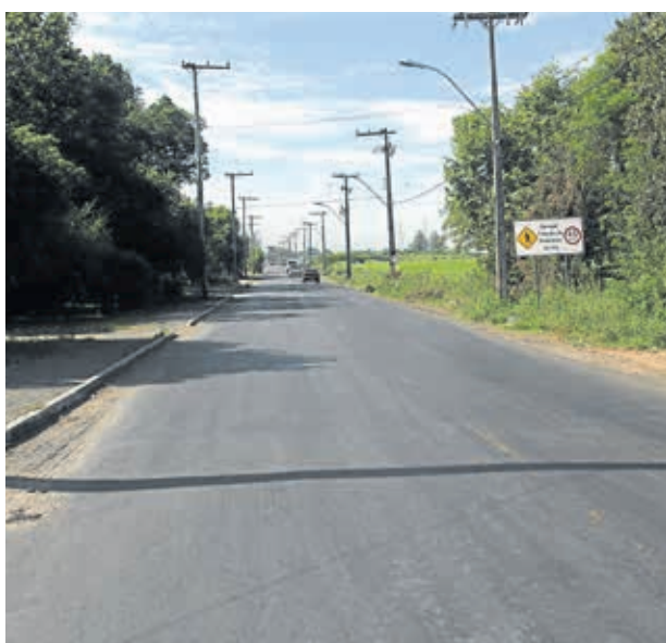
Asfalto da Rua Maria Isabel no Mato Grande
