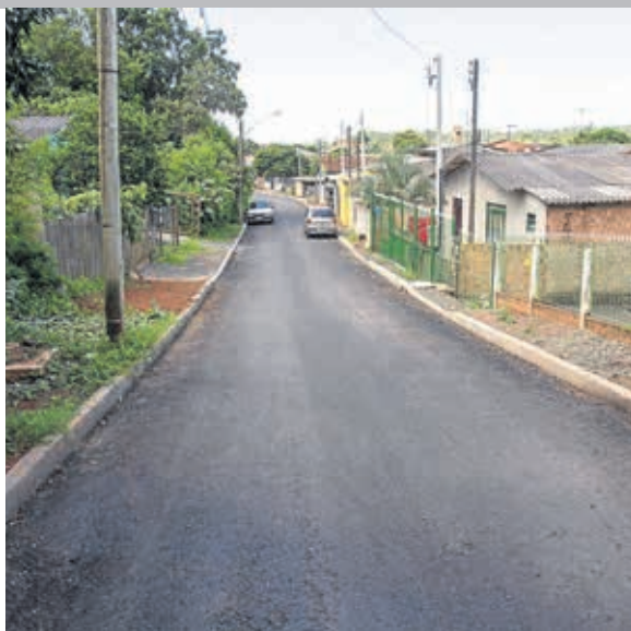
Asfalto na Rua B1 no Loteamento Conceição no Bairro São Vicente
