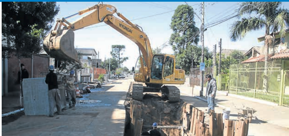
Construção de galeria pluvial na Rua Ana Neri, no bairro Rio Branco
