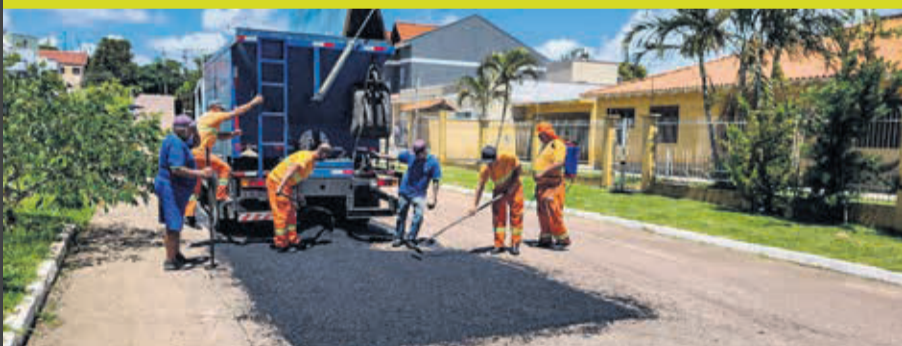
Usina de asfalto própria: 1.034 toneladas produzidas para a operação tapa-buracos (foto) e asfaltamento de pequenas vias
