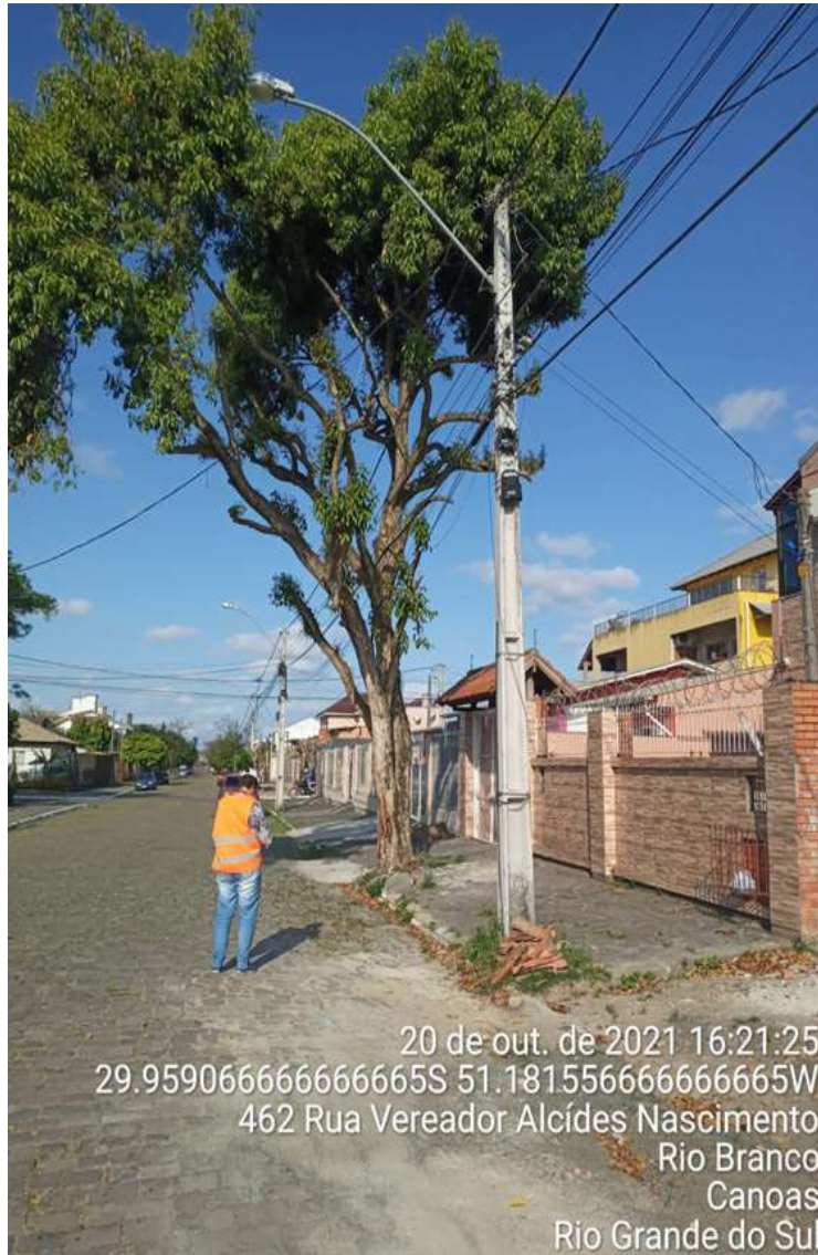
Figura 50 - Exemplo de ponto com obstrução da iluminação por árvores
