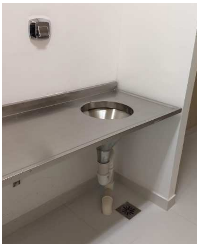
Imagem 24: Tampo em inox com expurgo, sifão em tubos de pvc e acionamento por válvula de descarga
